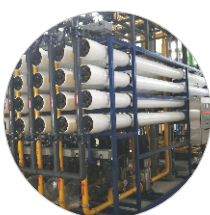
工业水处理 Industrial Water Treatment
